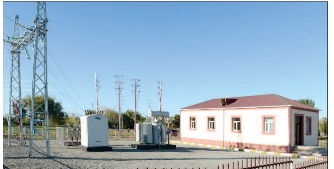
Şərur rayonunda 35/10 kilovoltluq "Xanlıqlar" elektrik yarımstansiyası
