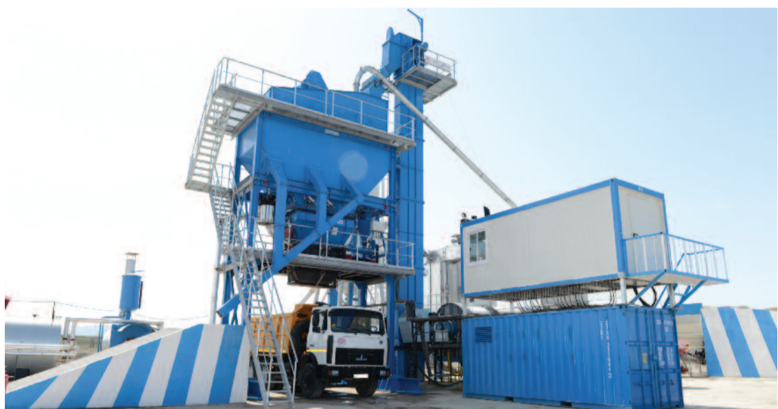
Naxçıvan Şəhər Abadlıq və Təmir-Tikinti İdarəsində istehsal gücü saatda 125 ton olan Asfalt-Beton Zavodu
